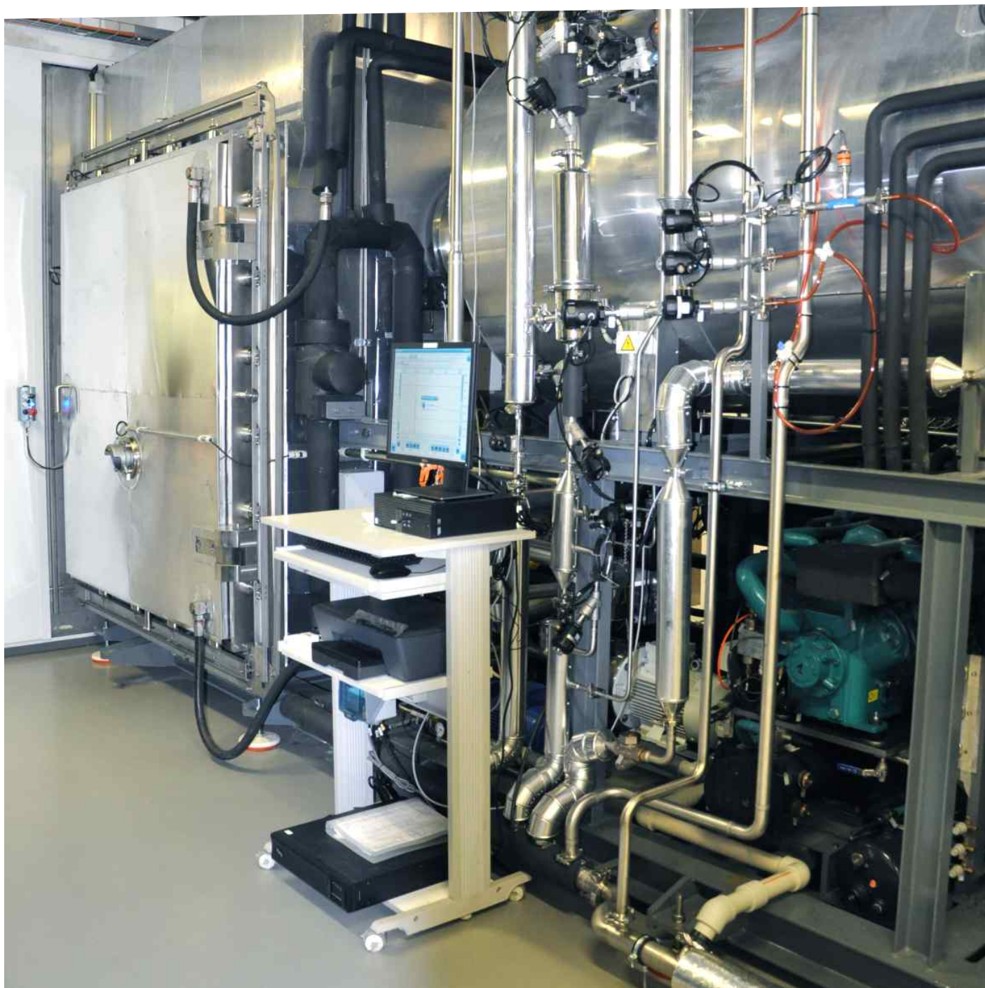
Moderní lyofilizační zařízení LYOMEGA 200 obomí svou kapacitou 110 000 kusů lékovek o objemu 3 ml a automatizací lyofilizačního procesu, včetně automatického systému zakládání lékovek
